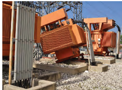
תמונה 3: תזוזת שנאי בתחנת הכוח ב-Port-au-Prince שבהאיטי, כתוצאה מרעידת אדמה בעוצמה 7 בסולם ריכטר שהתרחשה שם ב-2010
